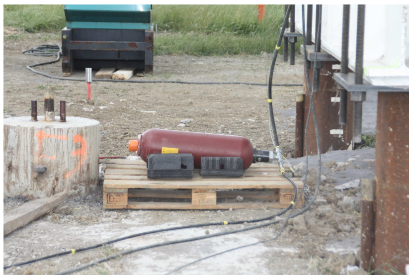
Figure 14 : photo de l'accumulateur
